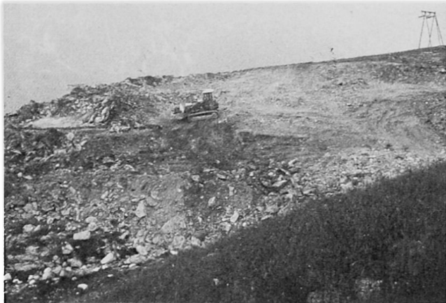
Landschaftsschäden durch Erdplanierungen. Ortsbestimmung: Piz Nair-Gebiet St. Moritz, Alp Giop Aufnahme: 21. 7. 1976
